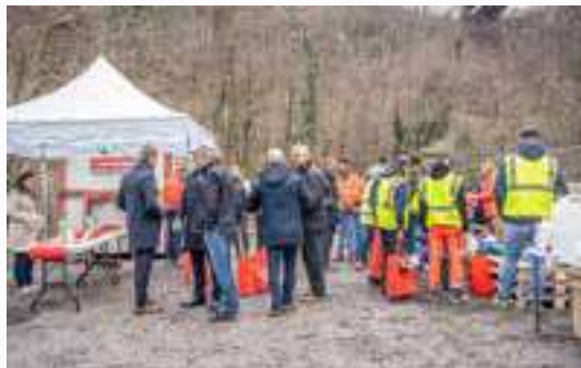
↑ Des élèves du CAP sur le chantier de sécurisation en eau potable de Saint Georges de Commiers et de Notre Dame de Commiers par le captage des Isles du Drac
