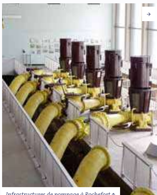
Infrastructures de pompage à Rochefort ↗
