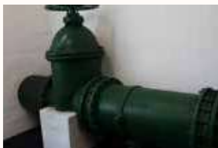
← Station de pompage Mails - St-Égrève
