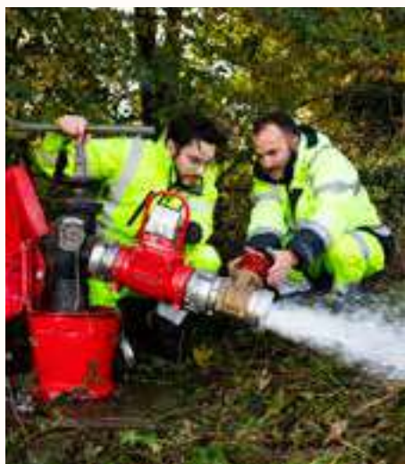
↑ Poteau incendie, Rafael et Alexis
