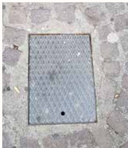
↑ Plaque de bouche incendie
